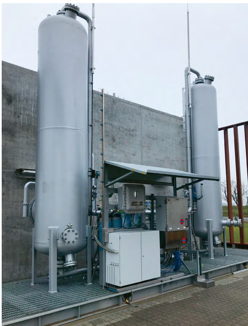
Deodoriseringsanlægget på St. Andst kompressorstation består af beholdere, der filtrerer odoranten fra gassen, og tilhørende rørføring og sampling-system. Foto: Energinet
