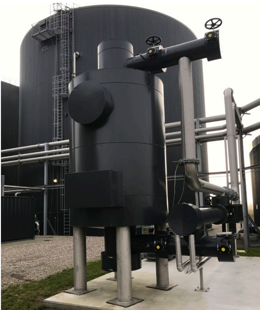
Kulfilter, der rensr rågas fra biogasanlæg.
