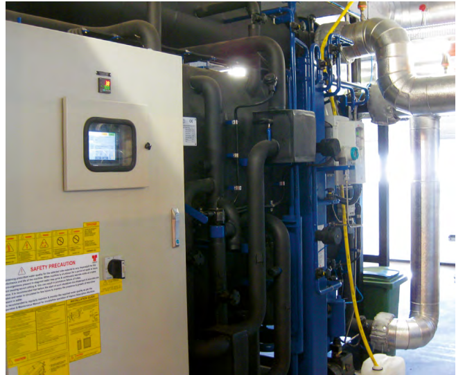
Figur 3: Gasfyrte absorptionsvarmepumpe i drift til både varmforsyning og køling på større dansk gartneri. Foto: DGC
