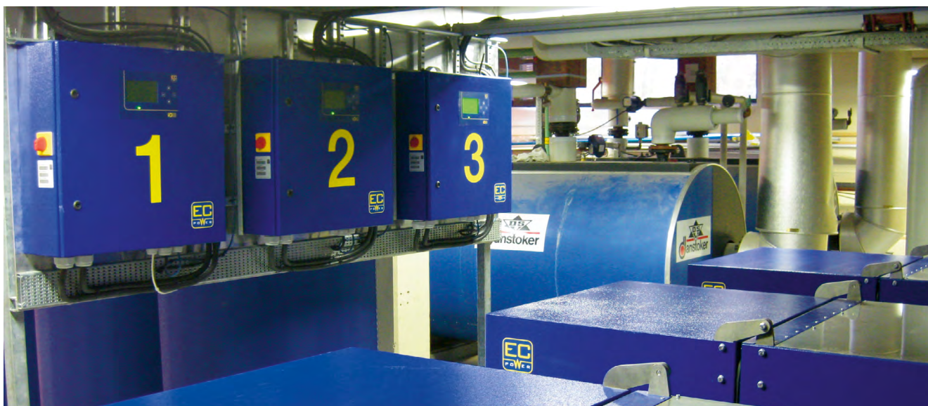
Energicentral på sportsanlæg, her er installeret minikraftvarme, varmepumper, kedler, varmelagre og varmegenvinding.
