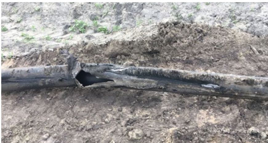
Nærbillede af bruddet på 6" rørledning. Hullets størrelse er 230 cm 2 .
