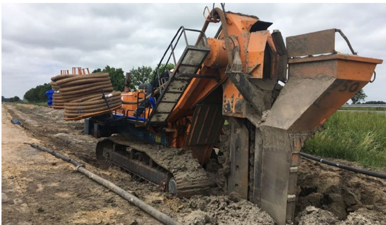
Den horisontale drænilægningsmaskine, som forårsagede et brud på rørledningen.
