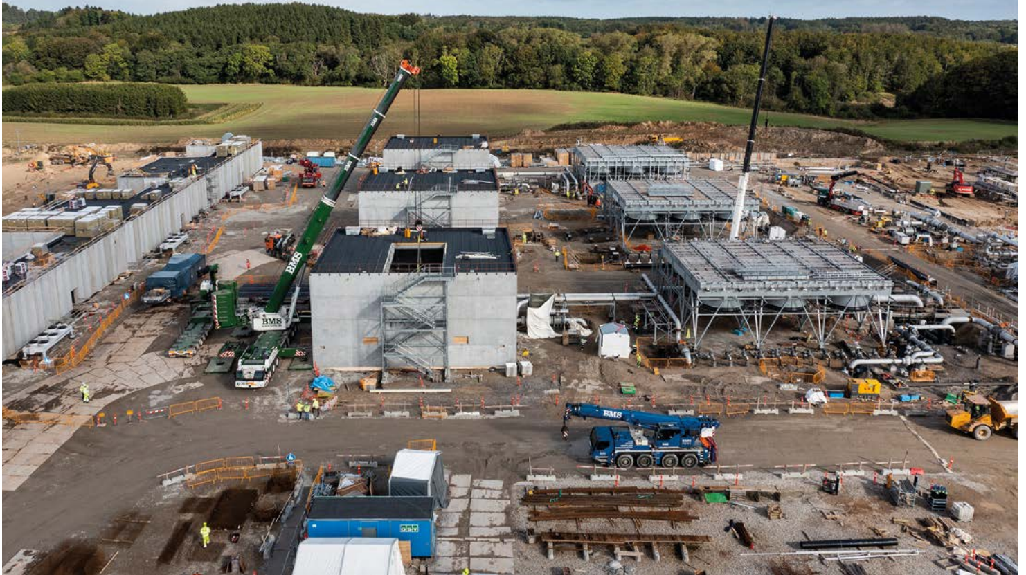
Til venstre ses servicebygningen, som skal rumme transformere, lager m.m. I midten de tre kompressorbygninger, hvor kranen er ved at løfte en kompressor på plads gennem taget. Til højre de tre sæt kølere, som skal køle gassen, inden den sendes videre. Foto: Energinet/Palle Peter Skov
